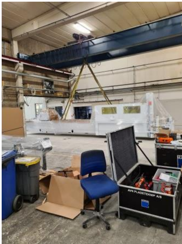
TRUMPF 5000 rørfiberlaseren ankom i sidste uge til Heléns Rør, og arbejdet med installationen blev straks indledt.
